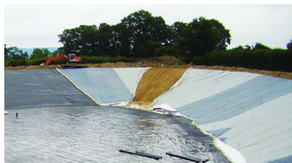
Foto: Vandreservoir med syntetisk beklædning. Fra hæftet "Thinking about an irrigation reservoir?".
